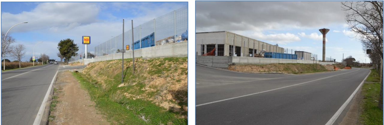
Fig. 1 e 2. Via Nenni. Lotto MD Immobiliare: Panoramica sulla recinzione del lato SE e sulla struttura di vendita in fase di realizzazione. [Foto DSC_3549 da SE; Foto DSC_3599 da NW]
