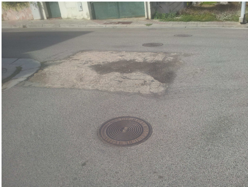
Foto 11 (Particolare fondo stradale irregolare)
