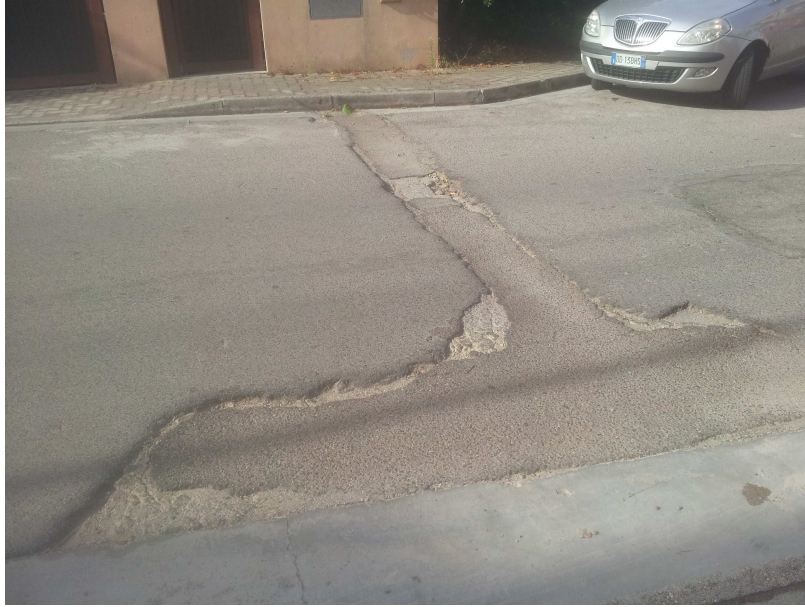
Foto 10 (Particolare fondo stradale irregolare)
