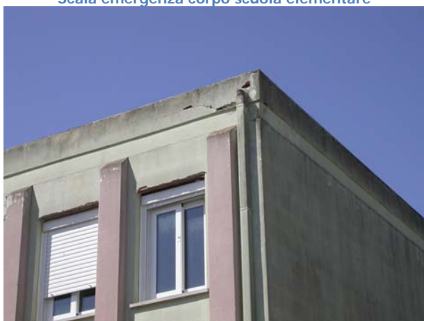
Lesioni in prossimità dei pluviali
