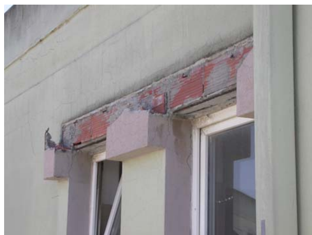
Lesioni sulle conici delle finestre
