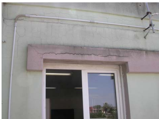
Lesioni sulle conici delle finestre
